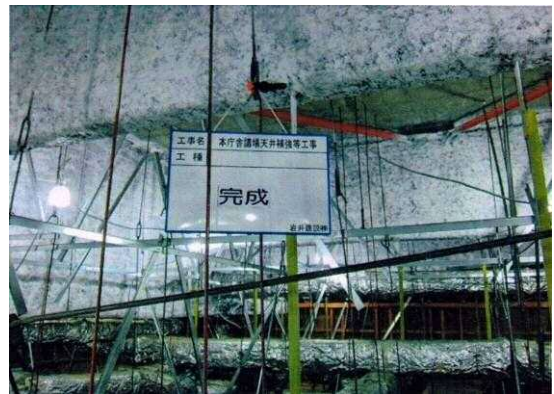
硬化剤で「封じ込め」されたアスベスト (低層部 4 階議場)
