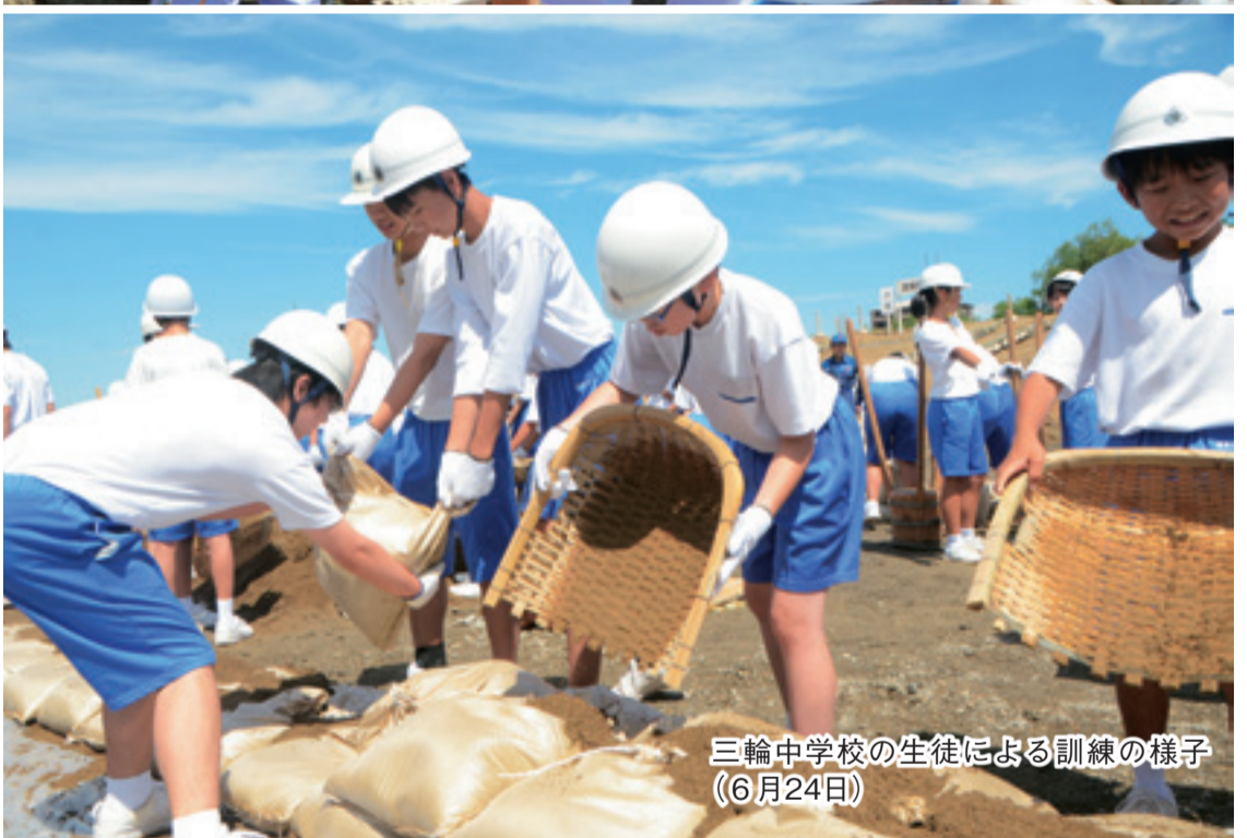
水防団員による、堤防の越水を防止するための「積土のう工」(6月24日)
