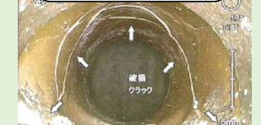
管の破損・クラック
