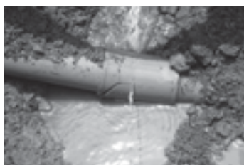
◀水道管の接続部分からの漏水 (布設後40年経過)
