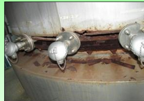
焼却炉の発錆状況
