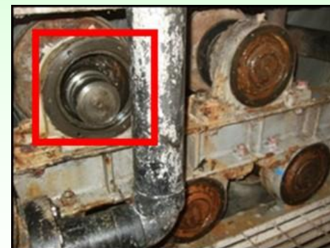
脱水機の破損・腐食状況
