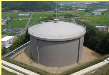
黒野第1配水池 設置年度：平成26年
