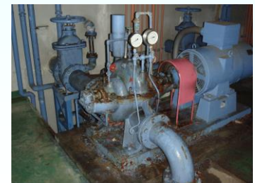
配水ポンプの発錆状況
