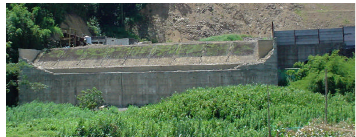
写真 擁壁状構造物の崩壊（復旧後）
