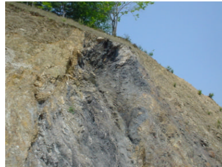
写真 切土のり面 断層破碎帯の小崩壊
