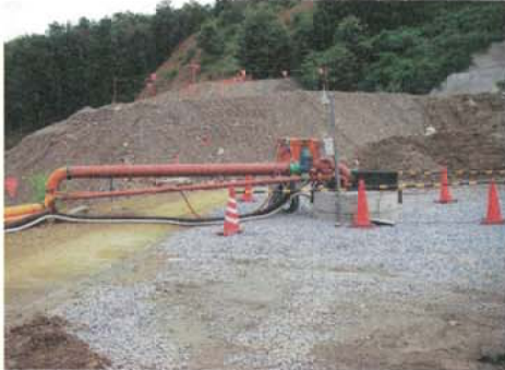
〈揚水井戸(外観)〉
