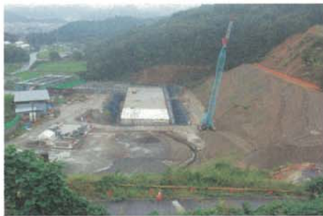
〈設置状況(選別施設設置前)〉
