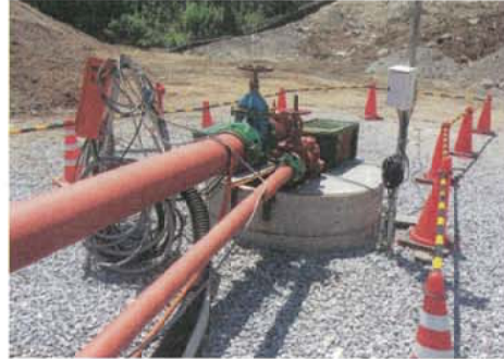
〈揚水井戸(上部)〉
