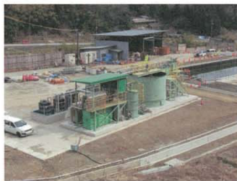
〈移設した水処理設備〉
