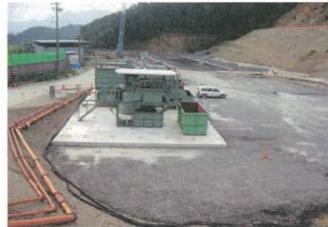
〈仮設の水処理設備〉
