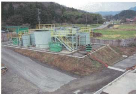
〈水処理設備(全景)〉
