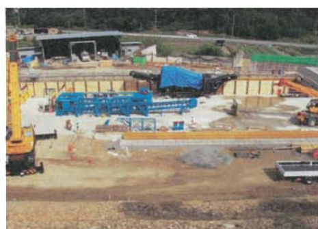
〈選別施設設置状況〉
