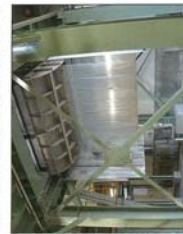
脱水設備(脱水汚泥貯留ホッパ)
