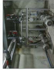
受入貯留設備(破砕ポンプ)
