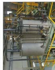
脱水設備(混和槽・凝集槽)
