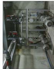
受入貯留設備 (破砕ポンプ)
