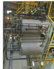
脱水設備 (混和槽・凝集槽)
