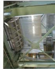
脱水設備 (脱水汚泥貯留ホッパ)
