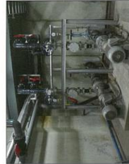
受入貯留設備 (破砕ポンプ)
