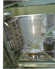
脱水設備 (脱水汚泥貯留ホッパ)
