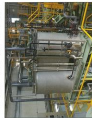
脱水設備 (混和槽・凝集槽)
