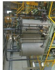
脱水設備 (混和槽・凝集槽)
