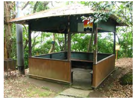
写真 2-19 老朽化した四阿(山上部)
