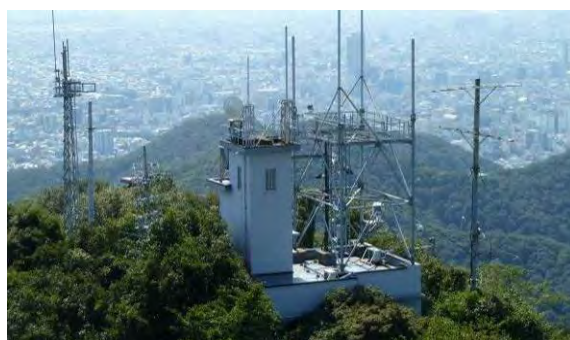
写真 2-36 無線中継所 (山上部)
