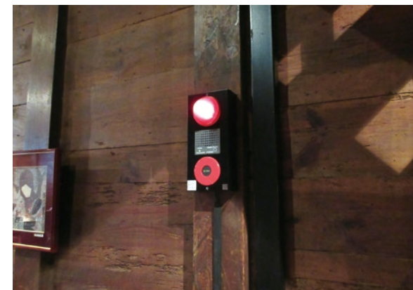
▲既設の防災施設(自動火災報知機)
