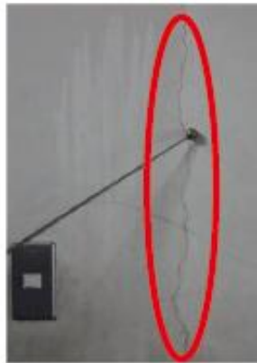
写真4. 内壁のひび割れ
