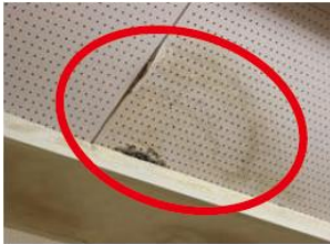
写真1. 天井材のしみ、破損
