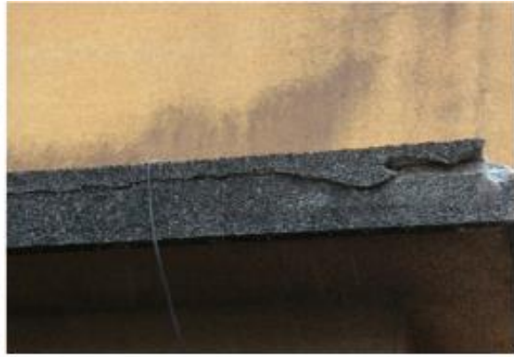
写真2. 外壁（庇の先端部）のひび割れ、欠損
