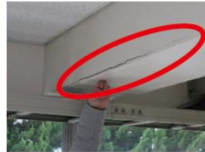
写真3. 梁の仕上げ材のひび割れ
