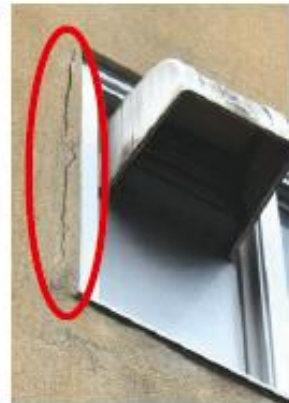
写真6. 外壁のひび割れ
