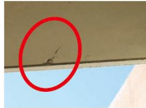
写真2. 階段裏のひび割れ
