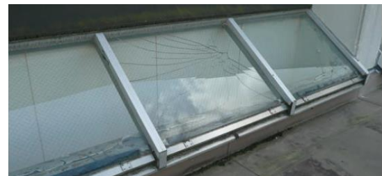
写真1. 窓ガラスのひび割れ
