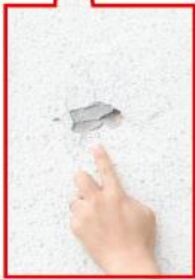
写真3. 外壁の浮き、剥落
