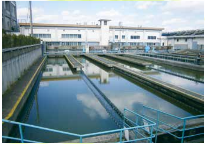
最終沈でん池(北部プラント)
