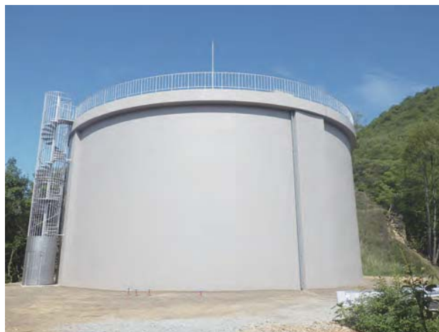
黒野第1配水池
