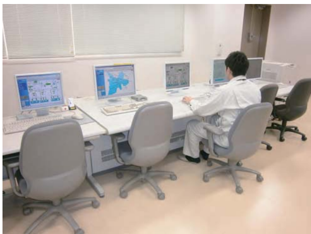
水道施設監視装置
