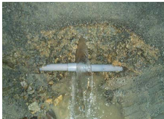
塩化ビニル管(TS 継手部)の漏水事故例 (口径φ50 mm、昭和 47 年度布設)
