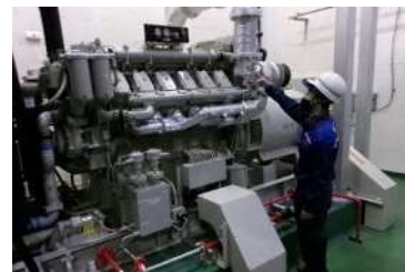
自家発電設備の点検訓練
