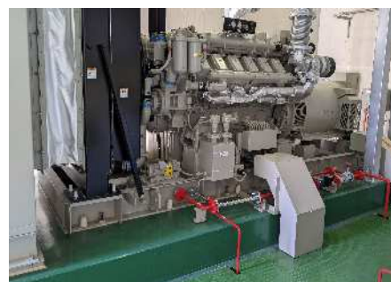
雄総水源地 自家発電設備
