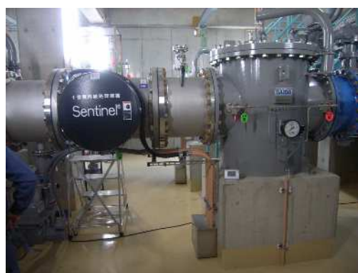
雄総水源地 紫外線処理装置
