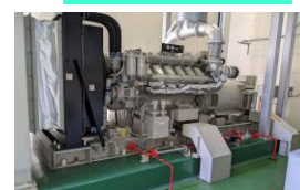
自家発電設備
