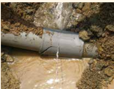
塩化ビニル管（継手から漏水）
