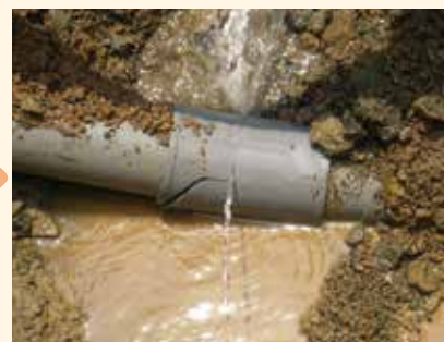
塩化ビニル管（継手から漏水）
