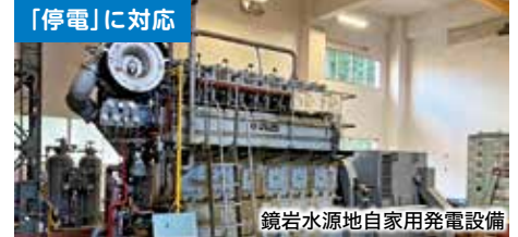
鏡岩水源の自家発電設備
