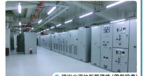
●鏡岩水源地新管理棟（電気設備）
