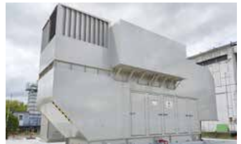
南部プラント自家用発電設備
