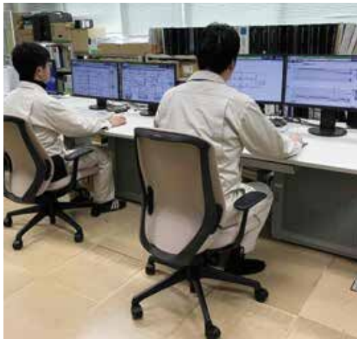
中央監視室の様子
