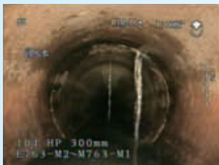
老朽化により水が浸入している下水道管
