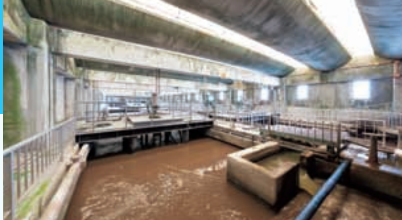
北部プラント 生物反応槽
