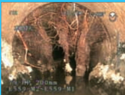
老朽化により木の根が侵入した下水道管
