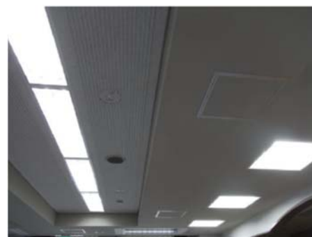
LED 照明（本郷公民館）
