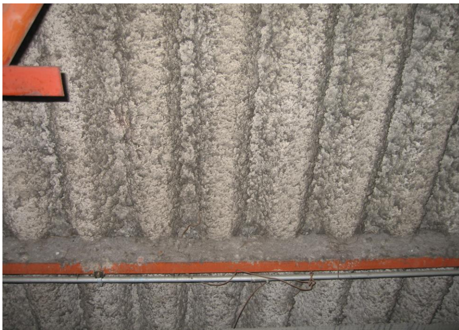
天井断熱材として吹き付けられた例
