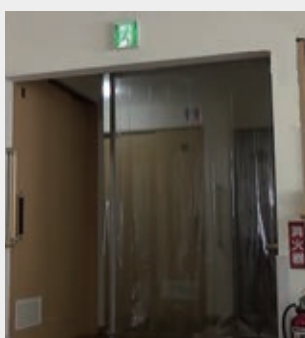
廊下と居室との間への遮煙のためのカーテンの設置例
