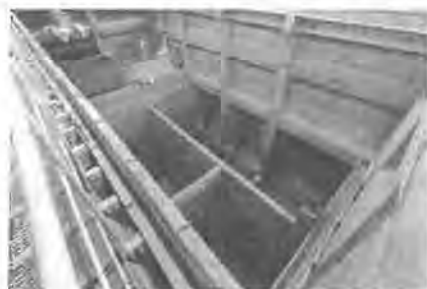
(1)資源ごみを貯留するピット
