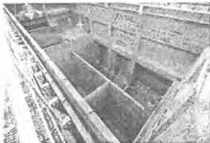
(1)資源ごみを貯留するピット
