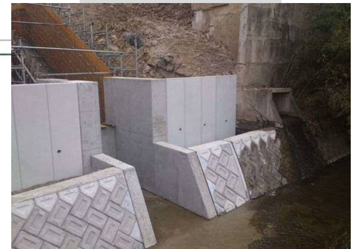
D-3 (排水) 状況写真
