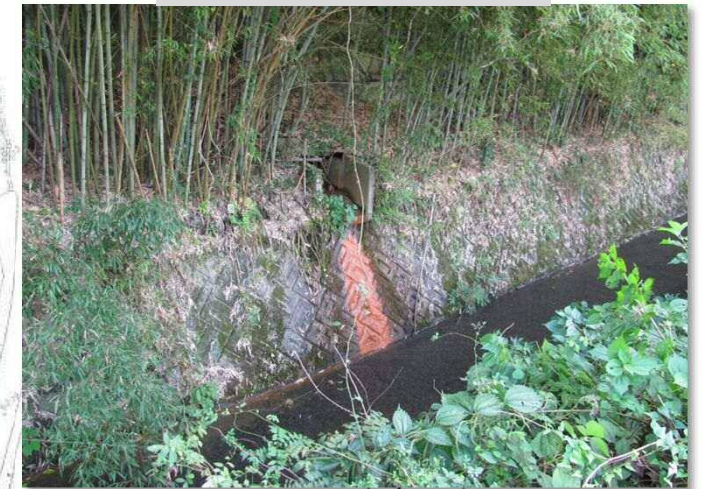
D-1 (排水) 状況写真
