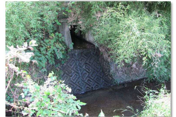
D-2 (排水) 状況写真
