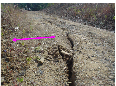
クラック（直下露岩右写真）
