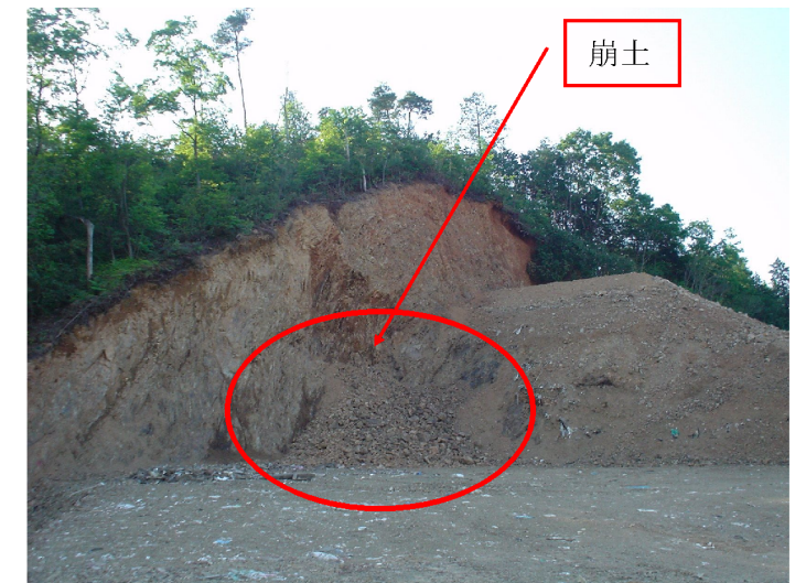
図 1.3.6 上部平坦面の東西辺切土斜面の崩壊状況
