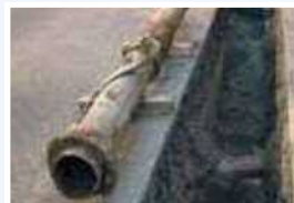
老朽化のため撤去された水道管
