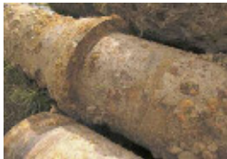
老朽化のため撤去された水道管
