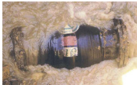
漏水した水道管
