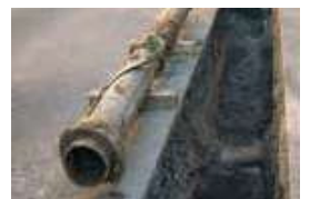
老朽化した水道管
