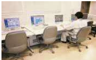
水道施設の監視室。市内全ての水源地を監視しています。
